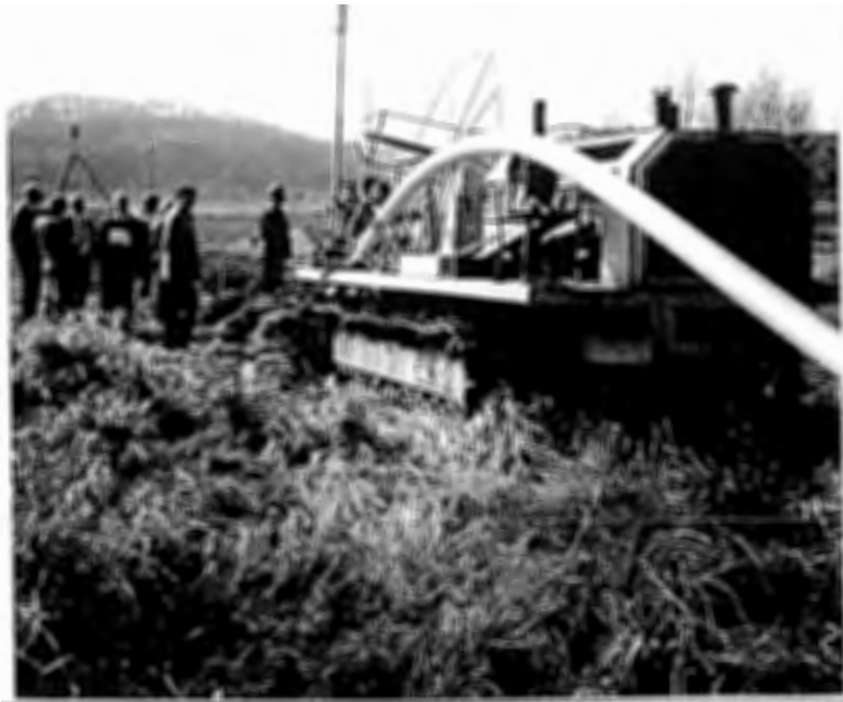
Fig 2. Plöjningsmaskin med gasrör som löper i båge över maskinen och ner i läggboxen.
