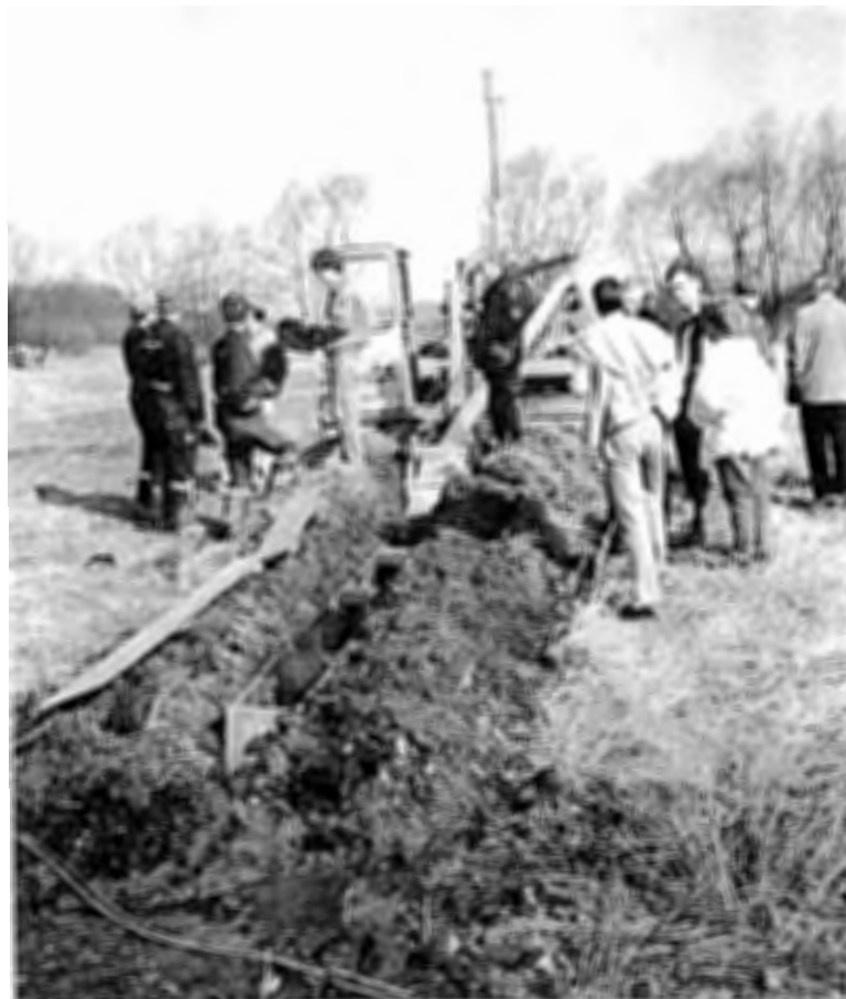
Fig 3. Läggboxens topptätning avlägsnades vid en visning av plöjningstekniken. Mitt i bilden, på en stång ca 2 m ovan plöjningsmaskinen, ser man en lasermottagare som möjliggör läggning med förutbestämd lutning eller nivå.
